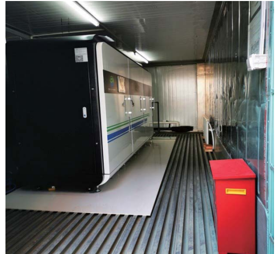
集装箱式废水处理装置内部
