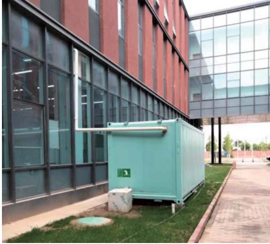
集装箱式废水处理装置外部
