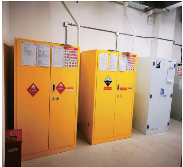
危险化学品库内部防爆柜
