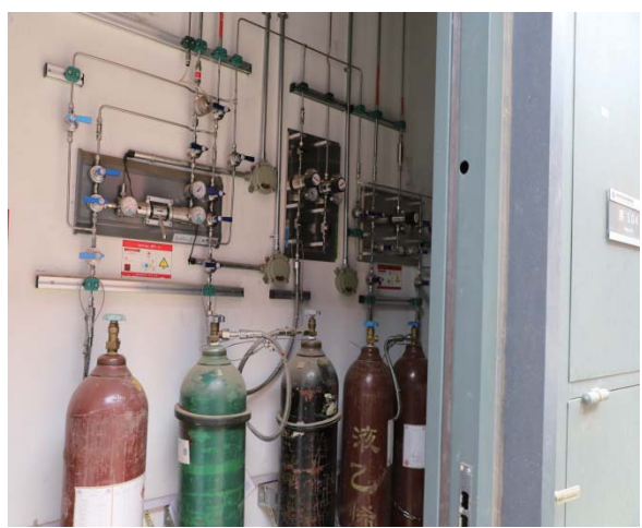
可燃气体间内部
