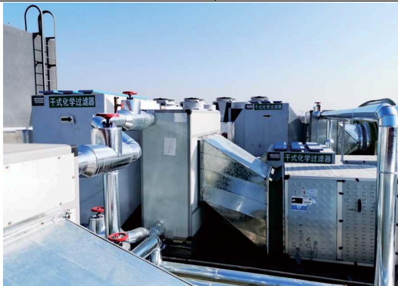
干式化学过滤器装置
