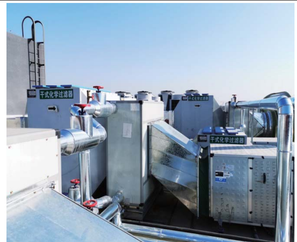
废气处理设施风机-隔声罩
