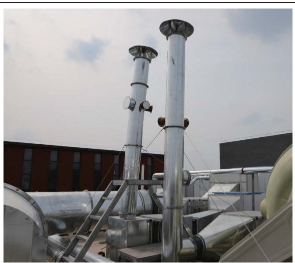
危废间和可燃气瓶间废气应急处理设施
