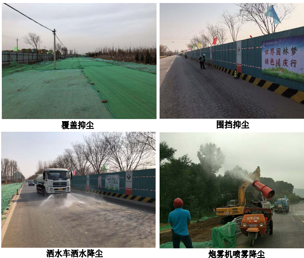
图 6-4 本项目大气环保措施照片
