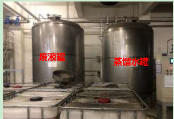
废液罐、蒸馏水罐
