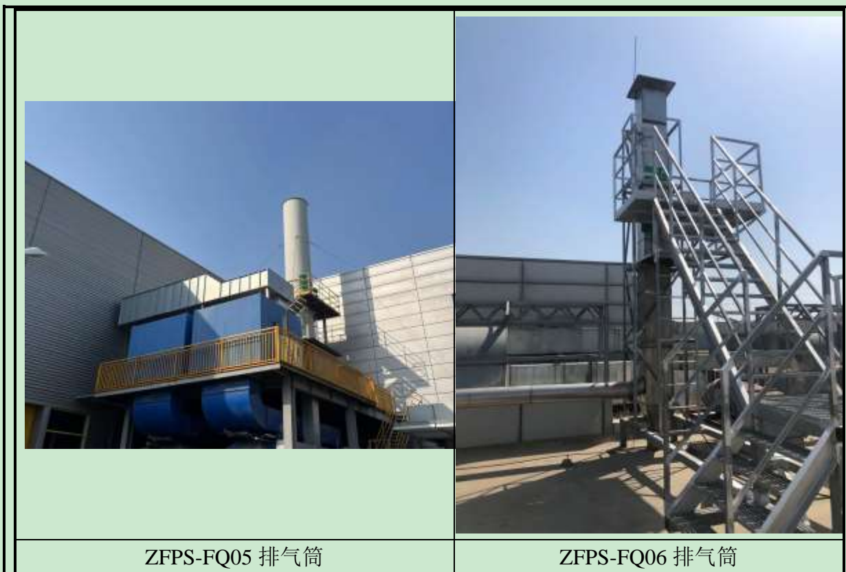
图 3-2 废气处理设施现状照片
