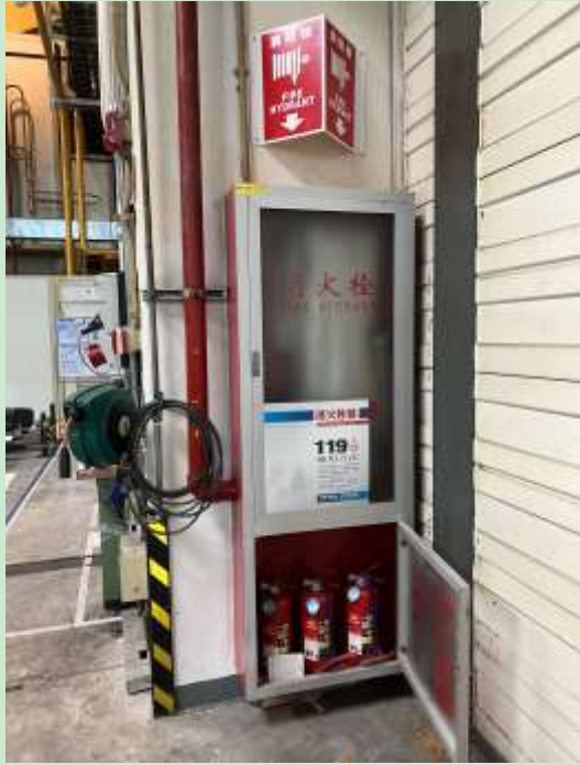
车间消防栓和灭火器
