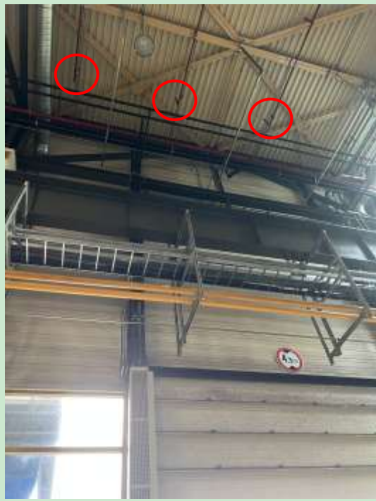
车间消防喷水管
