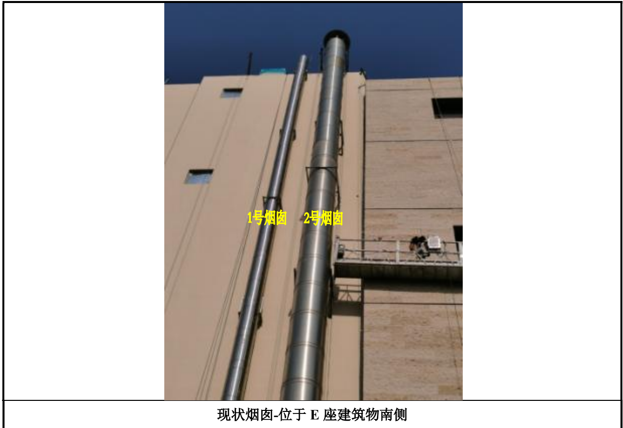
图 4-1 废气处理设施现状照片
