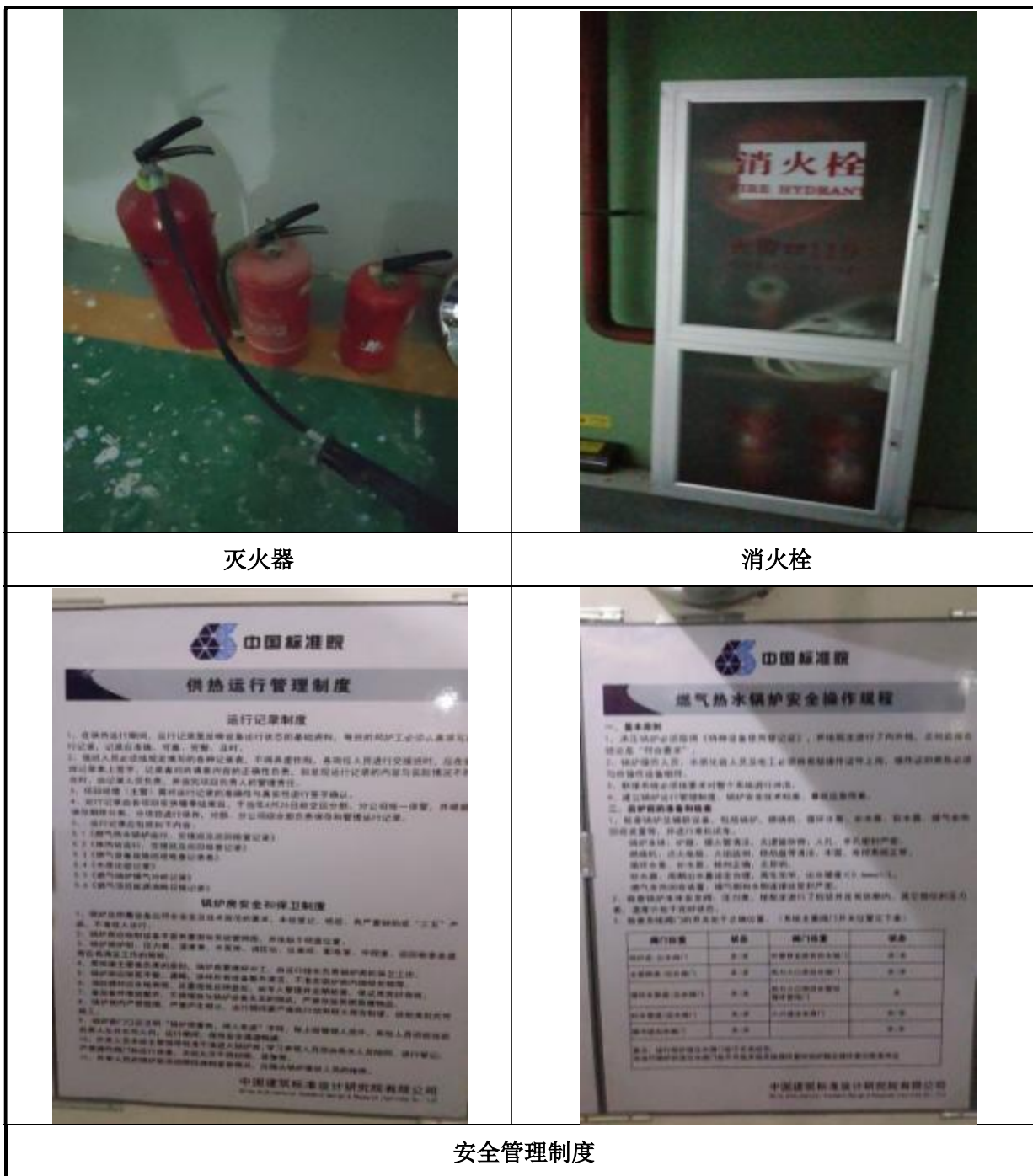
图 4-3 环境风险防范设施现状照片
