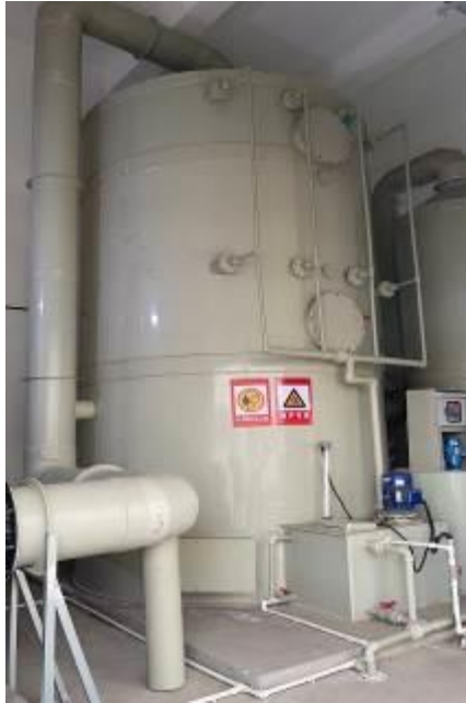
2#粪便消纳处理车间内除臭塔 （“生物过滤+植物液雾化”）
