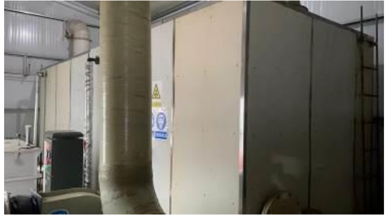
厂区污水处理系统（含综合设备间）废气除臭塔 （“喷淋水洗+生物过滤”）
