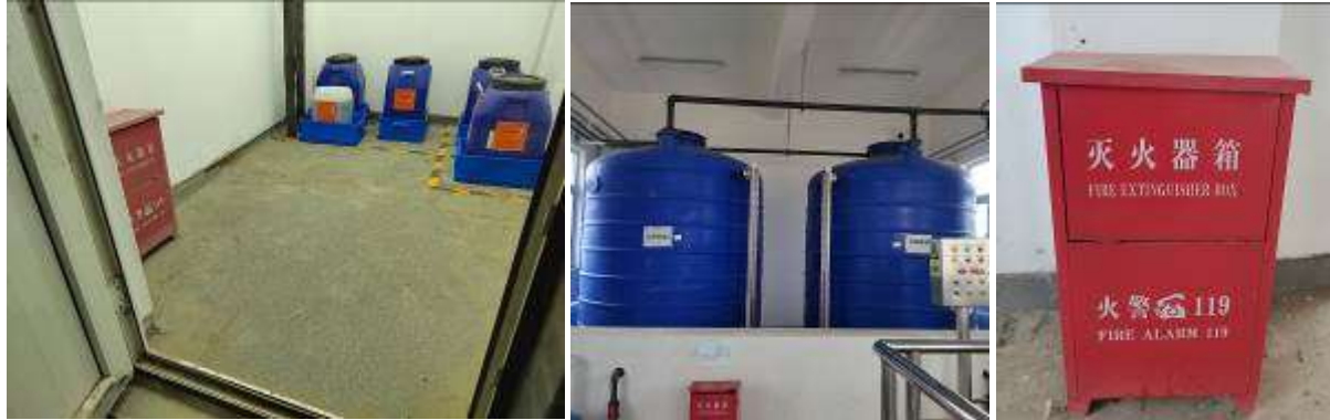
危废间设置防渗托盘 耐腐蚀 PVC 地板胶
