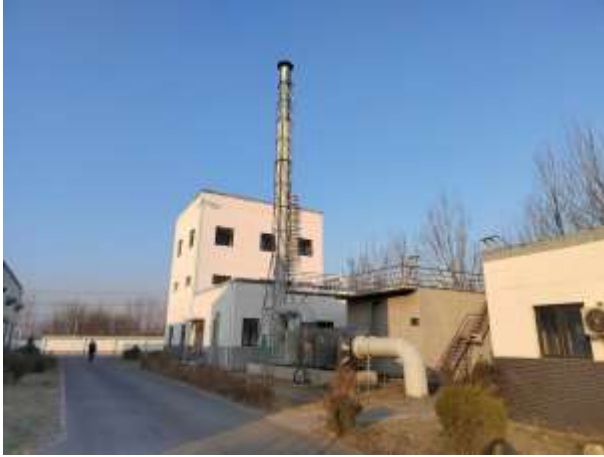
离子除臭系统+18m 高排气筒 DA001
