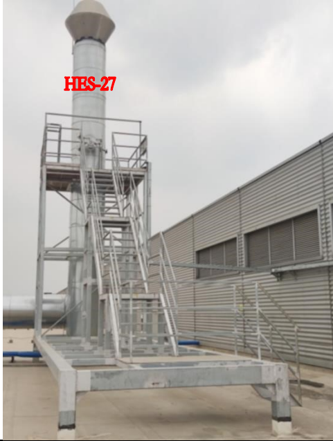
工艺燃烧废气排气筒（HES-27）
