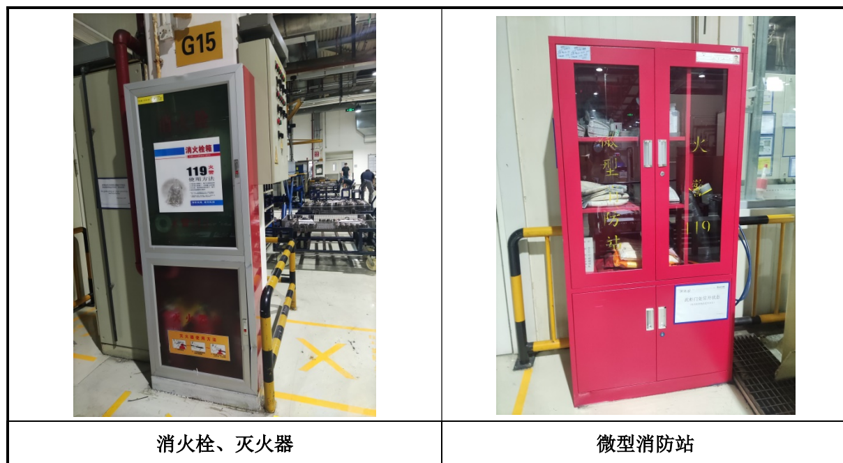
图 4 环境风险防范设施现状照片
