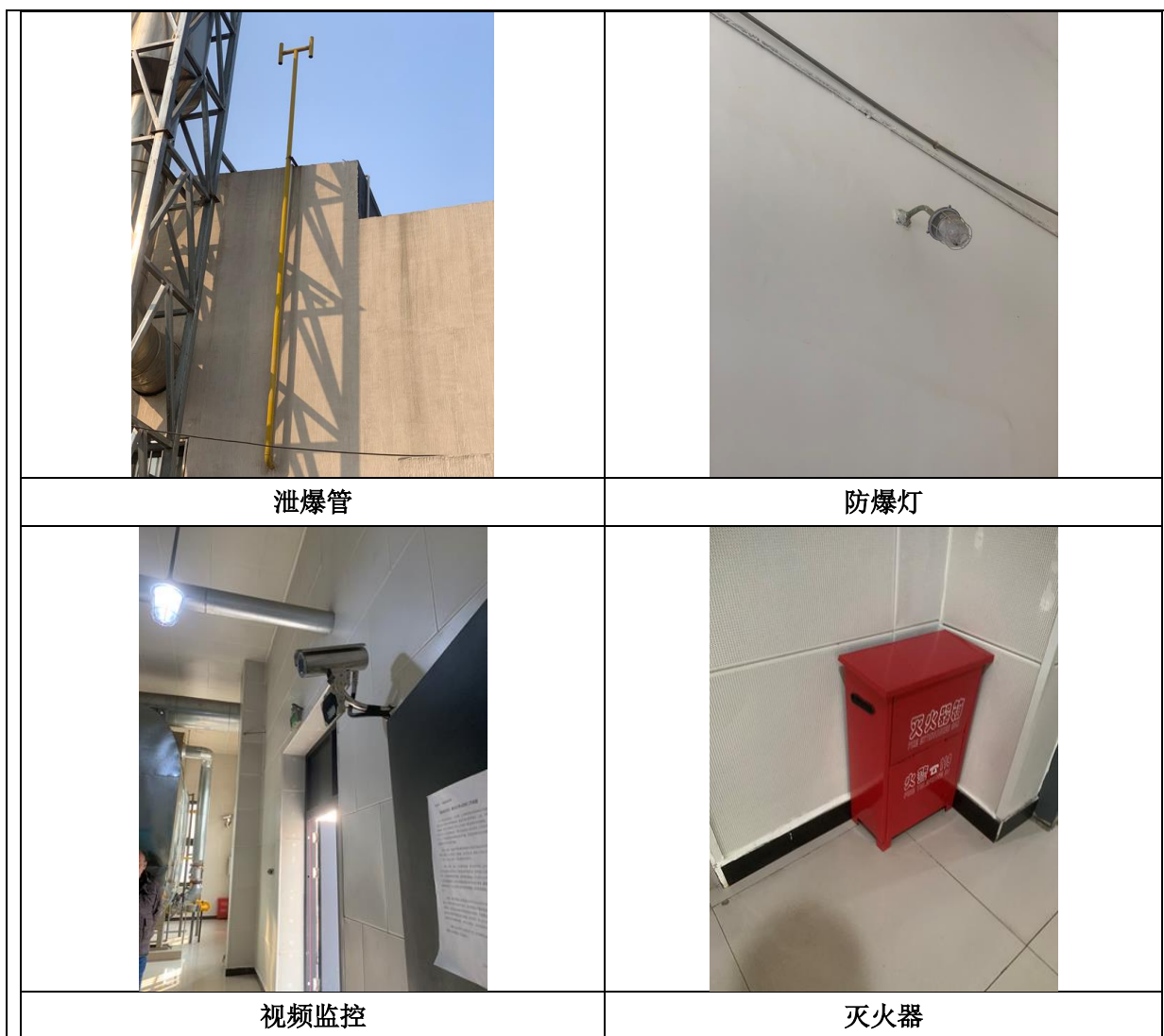
图3-9 风险防范设施照片
