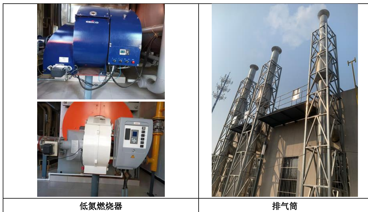
图 3-1 项目废气处理装置照片
