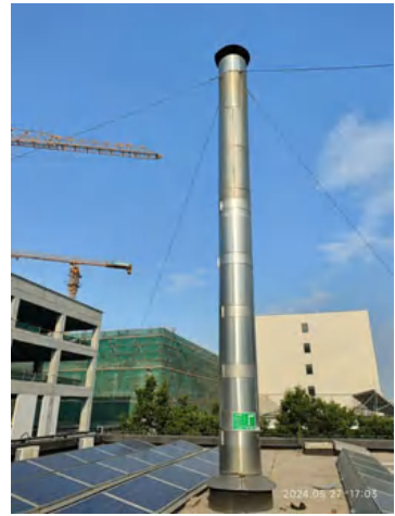
DA001排放口标识牌（远景）
