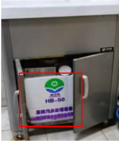
卫生间处医疗废水消毒处理设施
