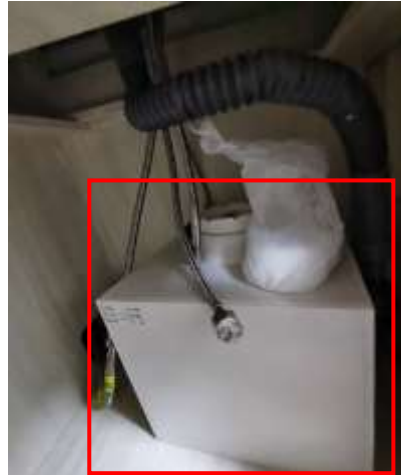
处理台处医疗废水消毒处理设施
