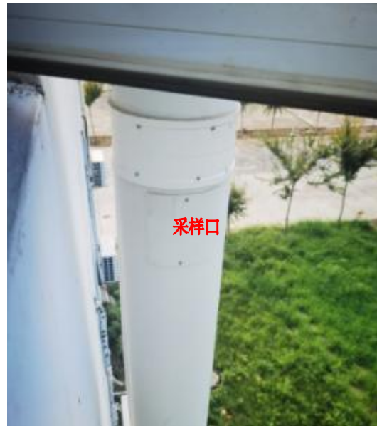
废气排气筒和采样口
