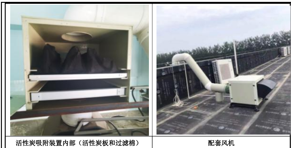
图4 废气处理设施现状照片
