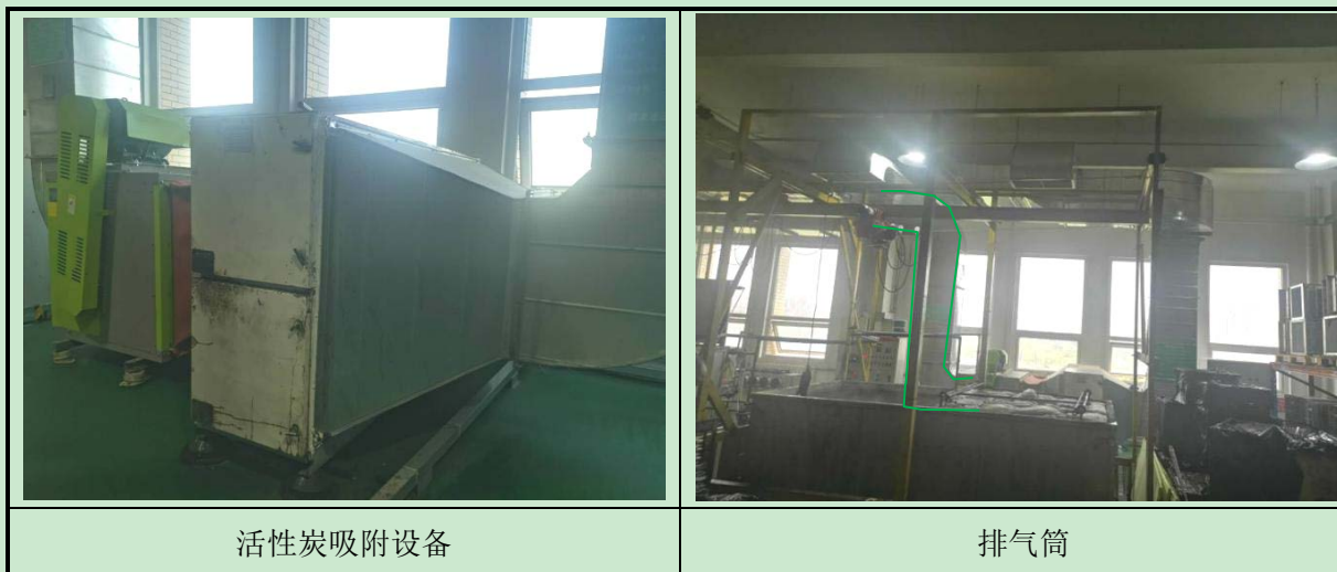
图4 废气处理设施现状照片
