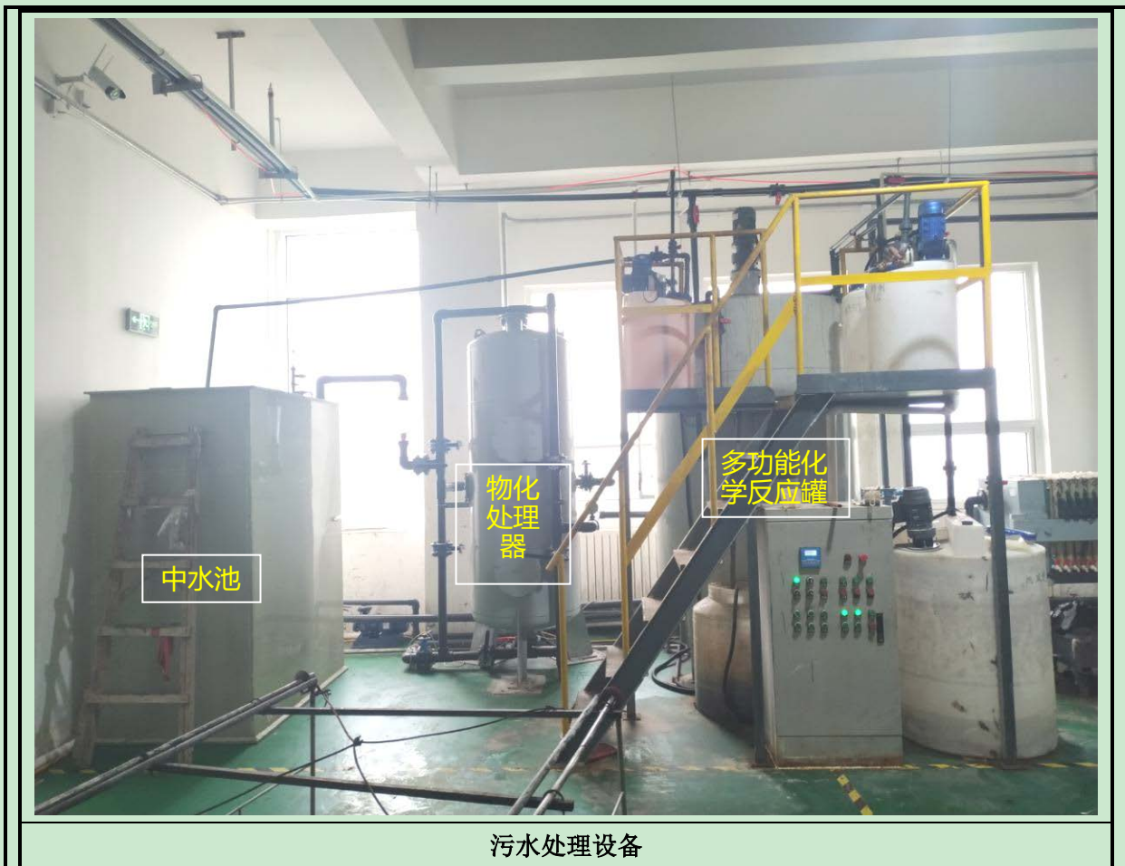
图 6 污水处理设备照片
