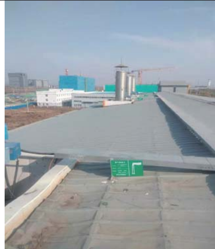
MF0003~ MF0005 燃气蒸汽锅炉排放口标志牌
