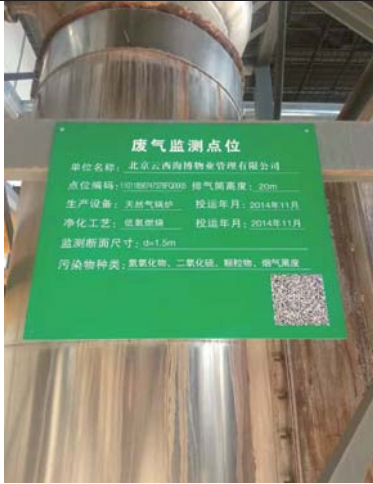
MF0005 燃气蒸汽锅炉监测点位标志牌
