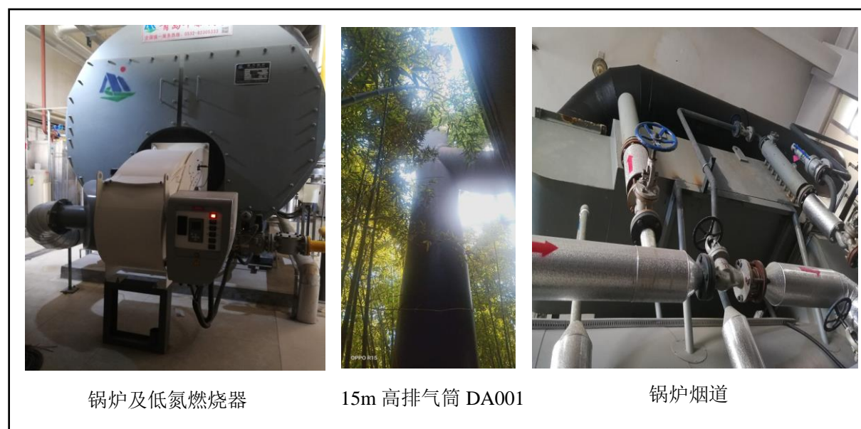
图 3 废气处理设施现状照片
