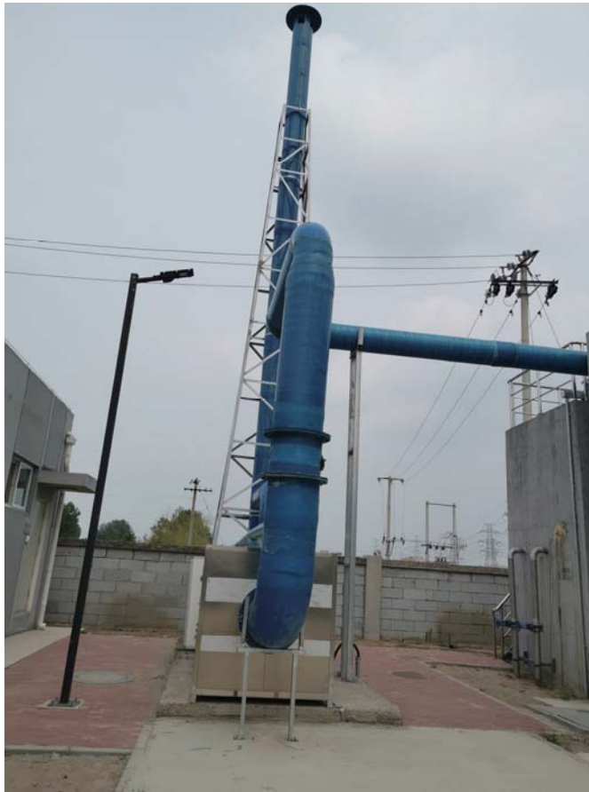
图 3-2 项目废气处理装置及排气筒照片
