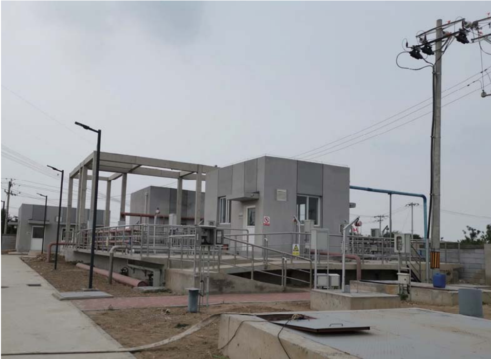
图 3-3 项目废水处理装置照片
