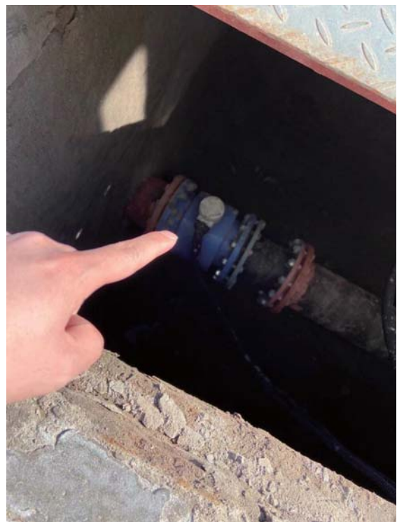
电磁流量计探头 (一次提升泵房提升泵的出水管路)
