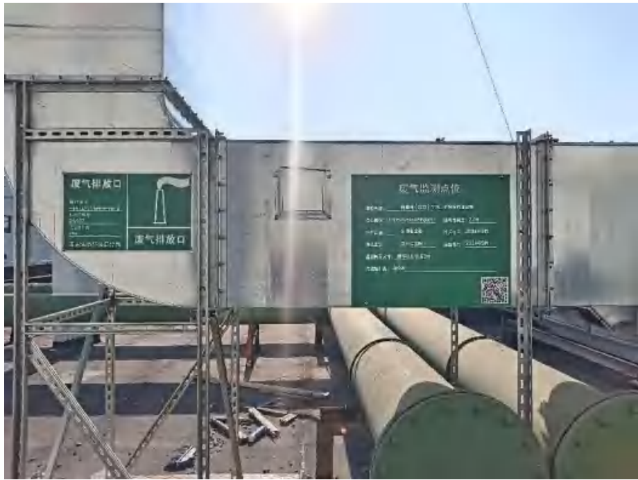
DA017 废气排放口
