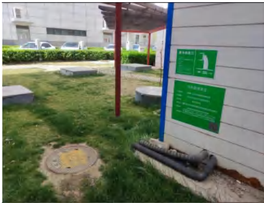
DW002 污水排放口
