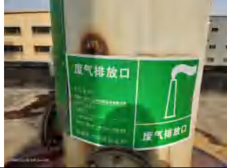
DA003 废气排放口
